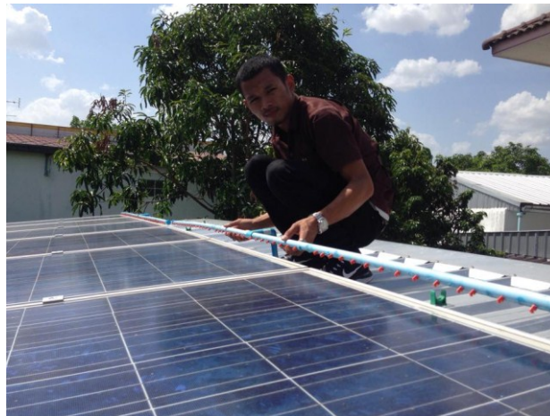
รูปที่ 3 การติดตั้งหัวฉีดสเปรย์น้ำบนแผงโซลาร์เซลล์
